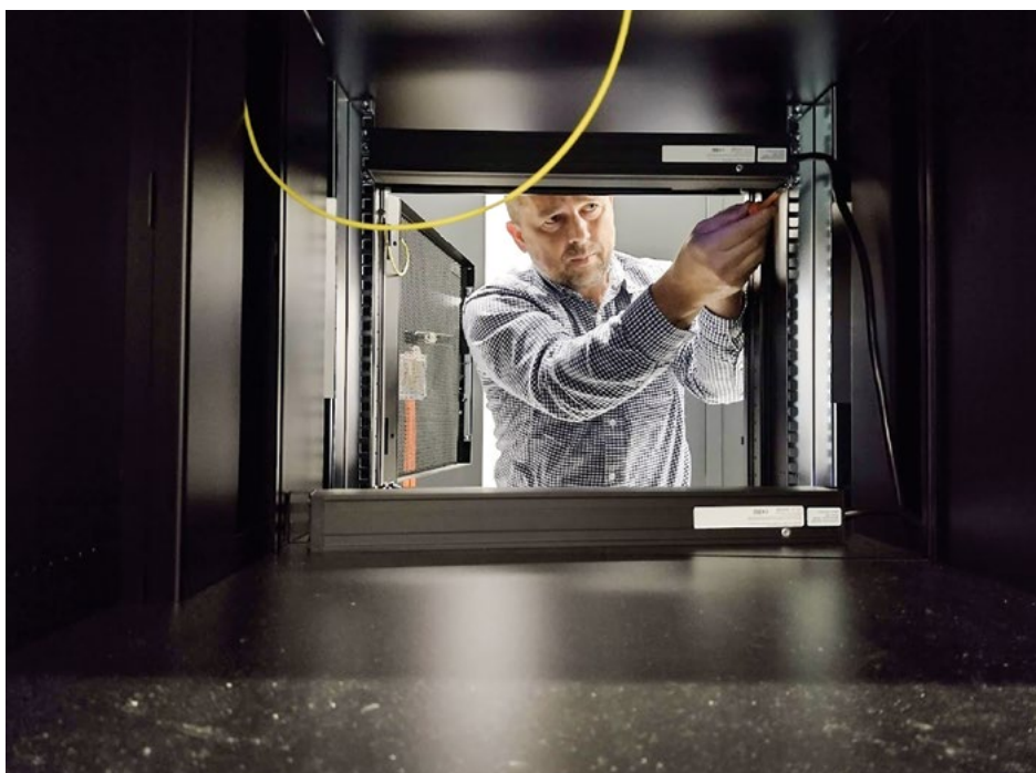
Instalace serveru ve švýcarském datacentru (součást sítě WEDOS Global)
